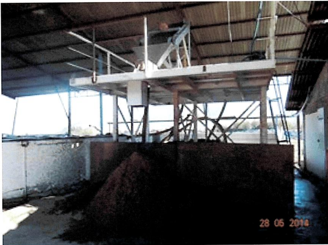
Fotografía 4: Vista general máquina separadora, con presencia de sólidos en el suelo (piso de hormigón).
