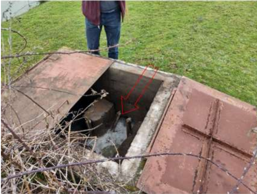
Figura 6: Compuerta metálica abierta y destruida
