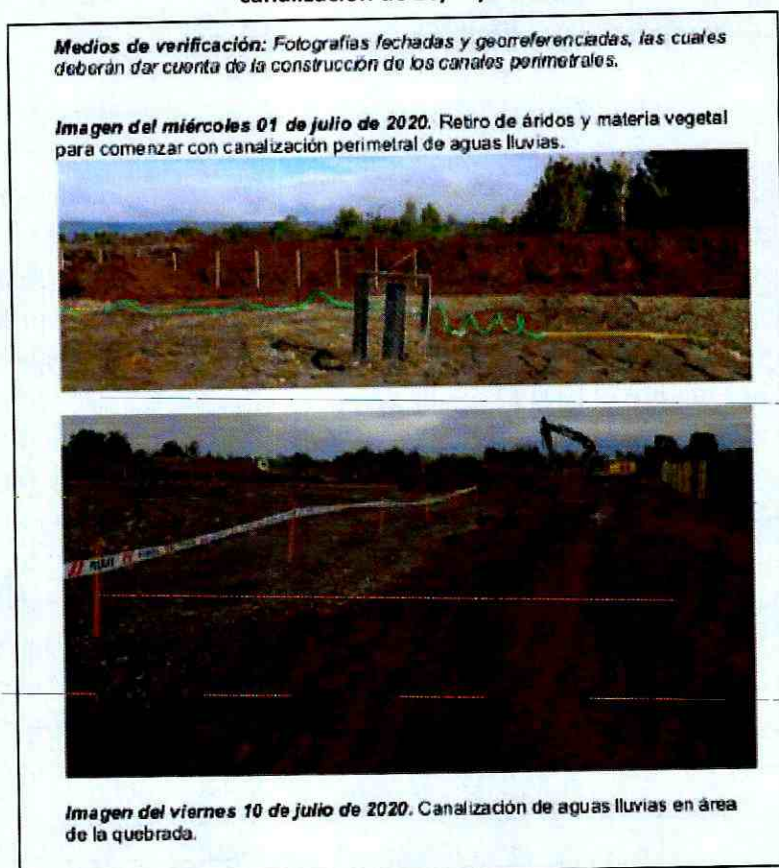
Imagen 4. Retiro de áridos y material vegetal para construcción de canal perimetral de 01/07/2020 y canalización de 10/07/2020
