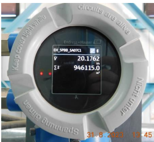
Fotografía N° 5: Caudal instantáneo y volumen acumulado de extracción desde pozo PR.
