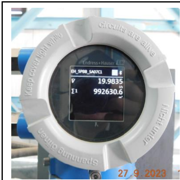
Fotografía N° 7: Caudal instantáneo y volumen acumulado de extracción desde pozo PR.
