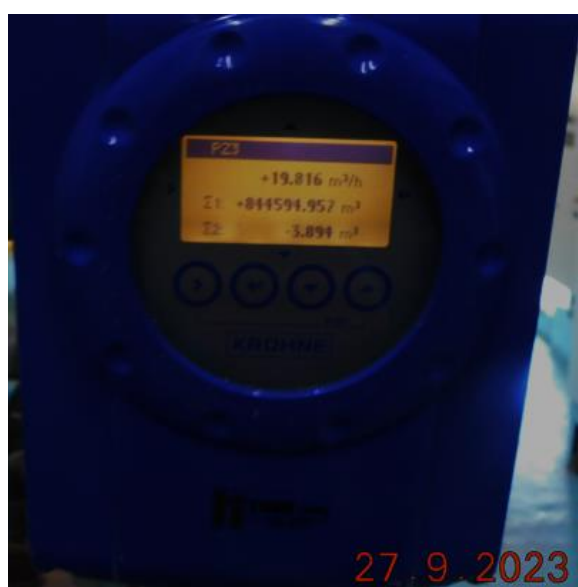
Fotografía N° 3: Volumen acumulado de extracción desde pozo P3.
