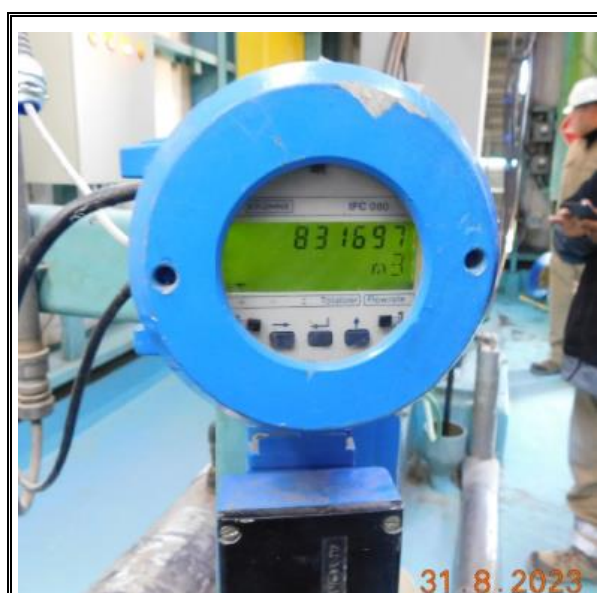
Fotografía N° 1: Volumen acumulado de extracción desde pozo P3.
