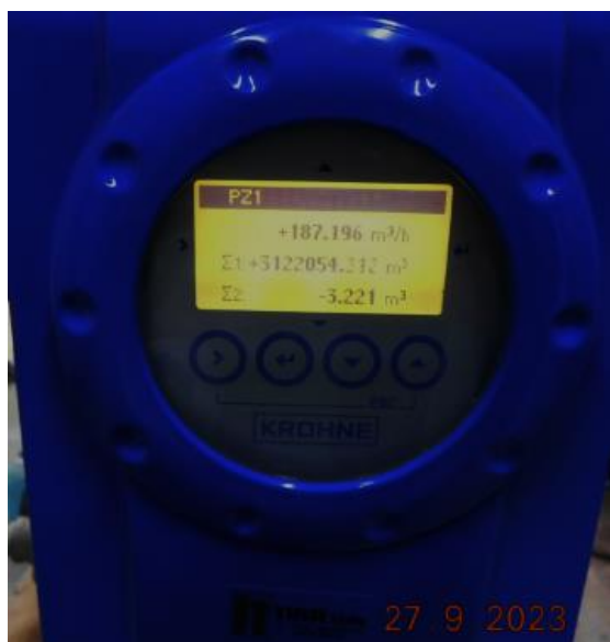
Fotografía N° 9: Caudal instantáneo de extracción desde pozo P1 (LA-1).
