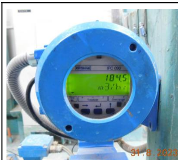
Fotografía N° 9: Caudal instantáneo de extracción desde pozo P1 (LA-1).
