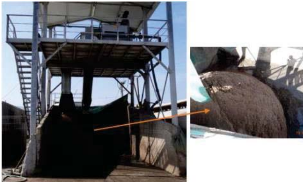
Fotografía 1. Recepción de guano. Arriba se ubican los filtros rotatorios y su fracción sólida cae por una manga hacia la losa
